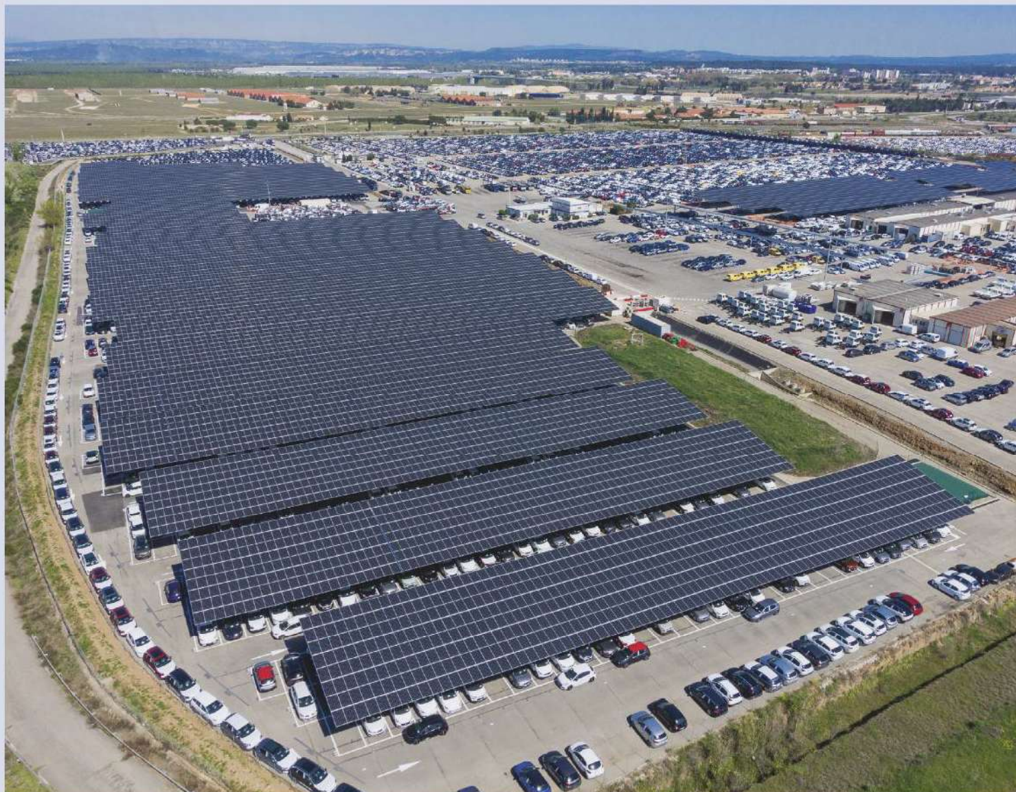
Centrale solaire de 9 MWc au Parc de Monteau, appelée STVA Sodemat, à Miramas dans les Bouches-du-Rhône. Un gigantesque parc de toit solaire ombrière Urbasolar sur le parking de 15 000 véhicules.
